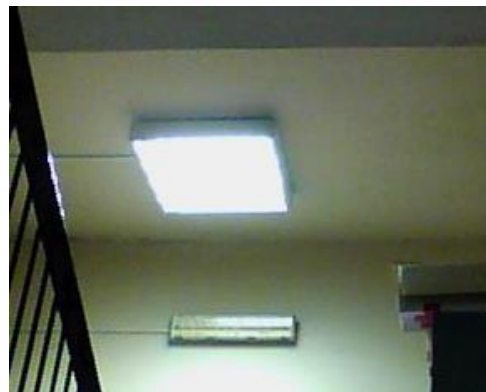
Figura 8.13 - Particolare dei corpi illuminanti attualmente installati
