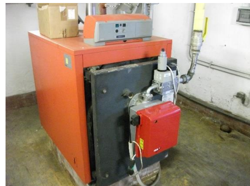
Figura 8.11 - Particolare del generatore di calore attualmente installato
