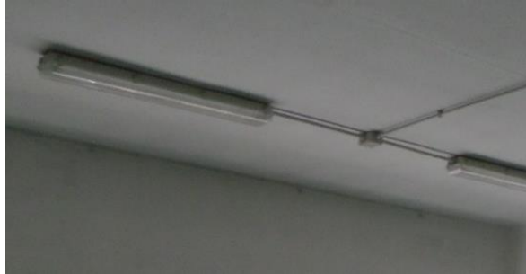
Figura 4.12 - Particolare dei corpi illuminanti installati a soffitto
