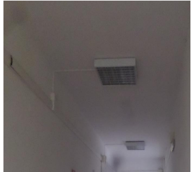
Figura 4.13 - Particolare dei corpi illuminanti ubicati nei corridoi
